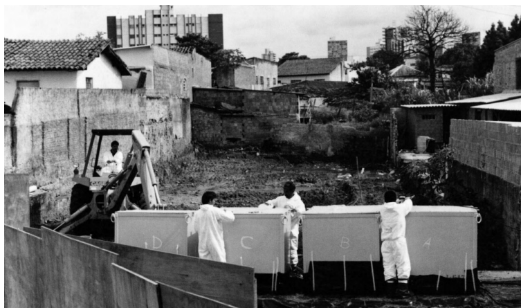
Foto 2 : o material é acondicionado em containers. Os que fazem o srviço estão sem capacete. Atenção para o operador da máquina: com trajes inadequados para a atividade.
